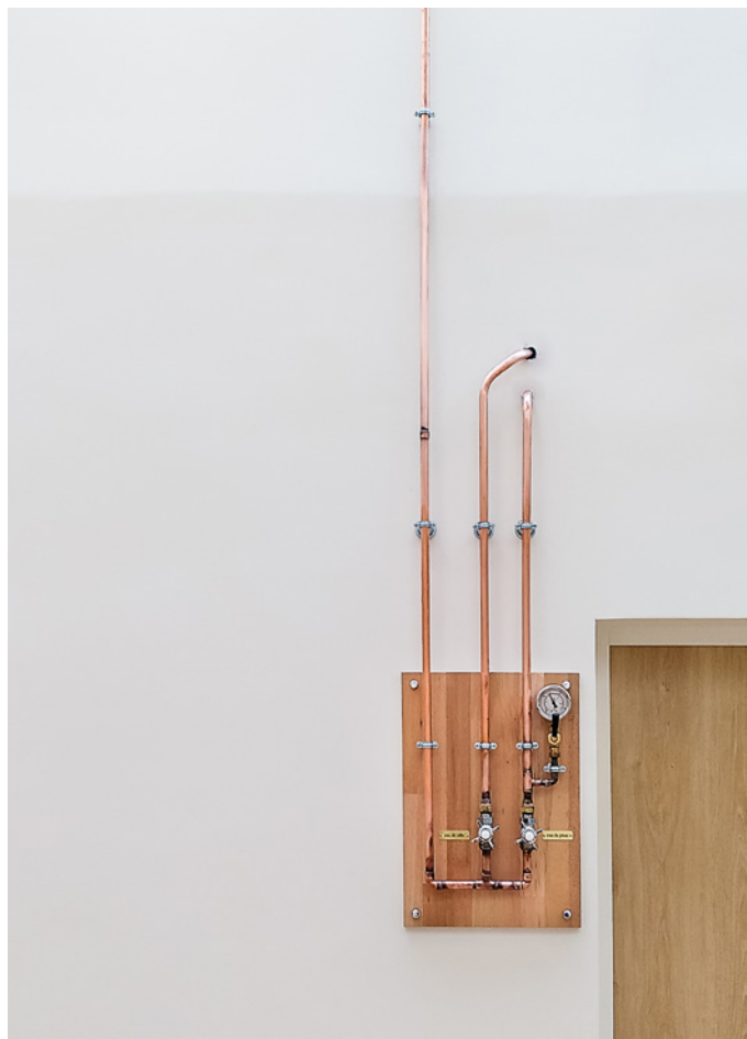
Commande lowtech du goutte à goutte utilisant les EP récupérées. Cuves de 200L d'eau de pluie installées sur la terrasse.
